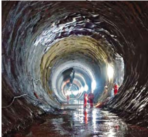
Lavori nel tubo ovest del comparto di Amsteg Fonte: Nuova ferrovia transalpina Rapporto sullo stato dei lavori 2008/II, 1 luglio - 31 dicembre 2008
