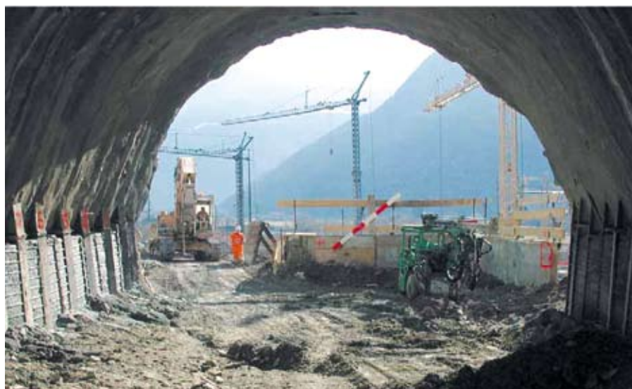
Lavori all'imbocco del portale sud di Raron - Fonte: Articolo della Marti Holding AG "Galleria di base Lötschberg Lotti Steg/Raron", 2008
